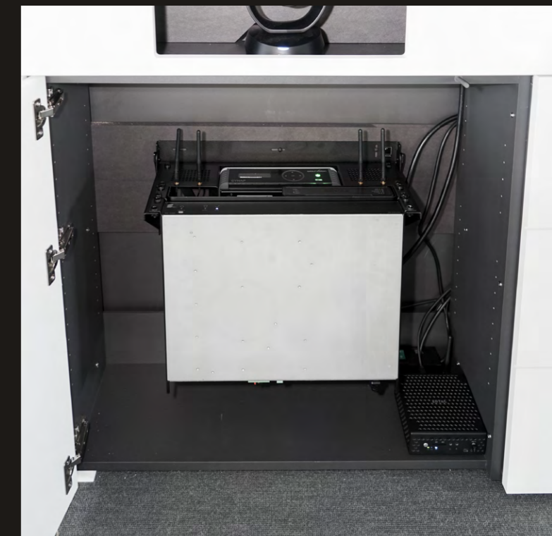
Die seitlichen Lautsprecherkorpusse sind mit Akustikstoff verblendet, im oberen Bereich finden Linien-Lautsprecher, unten Subwoofer Platz. (Abb. oben) Ein optionales 19"-Rack bietet 4HE (schwenk- und aushängbar) für die flexible und perfekt revisionierbare Technikintegration. (Abb. unten)
